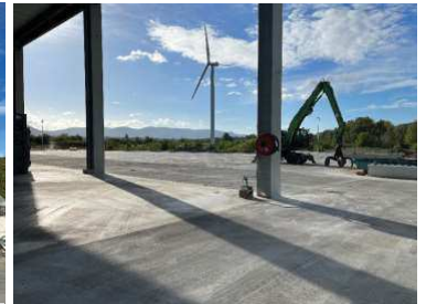
Plateforme SOLLUWASTE : exemple de dispositif du réseau d'extinction incendie dans partie ouverte du bâtiment (clichié TS 09/22)
