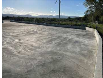
Plateforme SOLLUWASTE : angle sud-ouest de l'aire bétonnée, muret béton délimitant l'aire de rétention des eaux pluviales et des eaux d'extinction incendie. Un joint expansif assure l'étanchéité entre le mur et la surface bétonnée (clichié TS 09/22)
