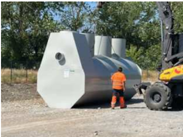
Plateforme SOLLUWASTE : déboureur/séparateur d'hydrocarbures sur le site avant sa mise en place (clichié TS 09/22)
