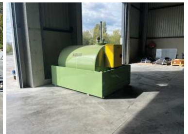
Plateforme SOLUWASTE : Stockage de 3000 l d'hydrocarbures et pompe de distribution sur cuvette de rétention elle-même sur dalle étanche, dans la partie fermée du bâtiment (cliché TS 09/22)
