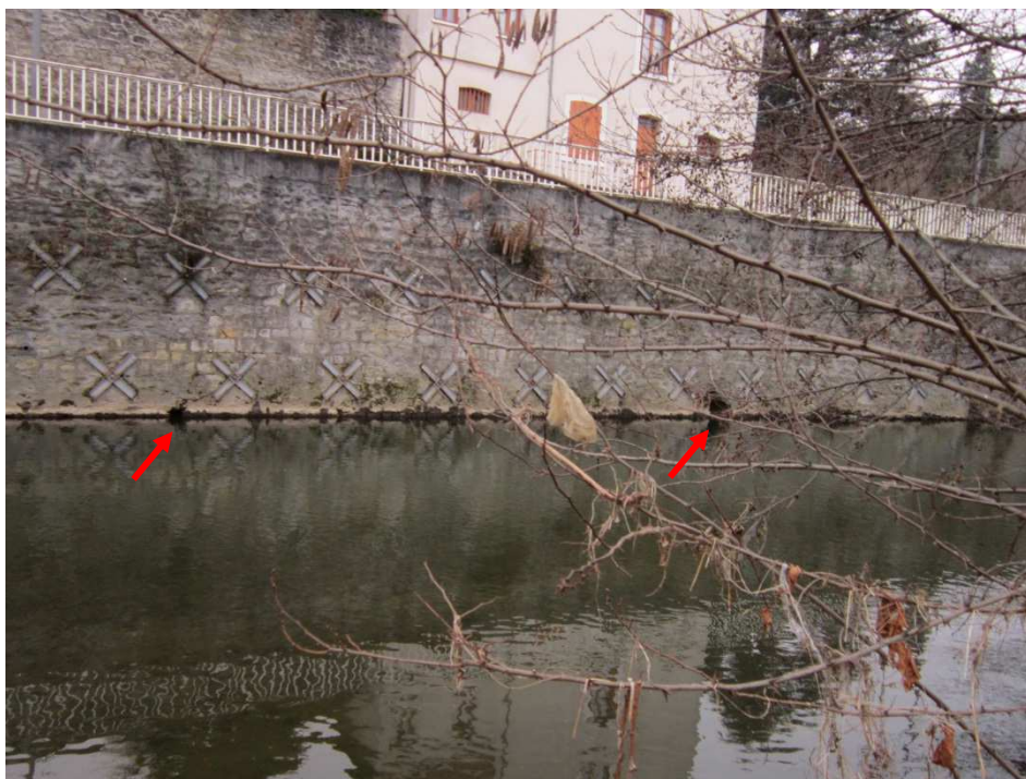
Vue des affouillements en pied d'ouvrage de soutènement rive droite
