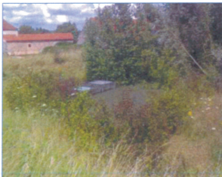
Photo du bassin de rétention
