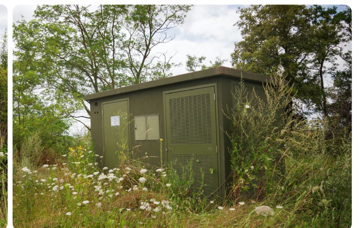
Poste existant à l'aire immédiate
