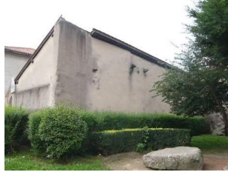
Vestiges du bâtiment jouxtant la Clôtra. Le préau a été adossé aux vestiges maçonnés.
