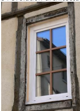
Fenêtre en rénovation dont les menuiseries créent des surépaisseurs.
