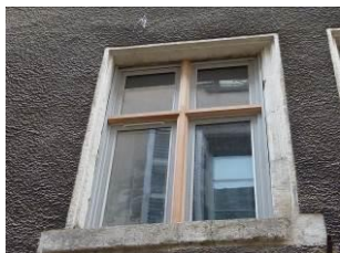
Faux meneaux inadaptés à la nature de la façade.
