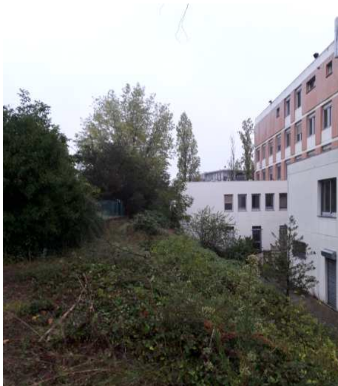
Photographie 17 : Présence de végétaux à l'arrière de la clinique
