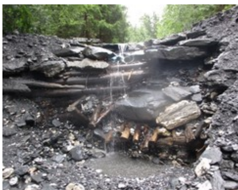
Figure 94: Aval du gué Barriaz incisé suite à la seconde crue
