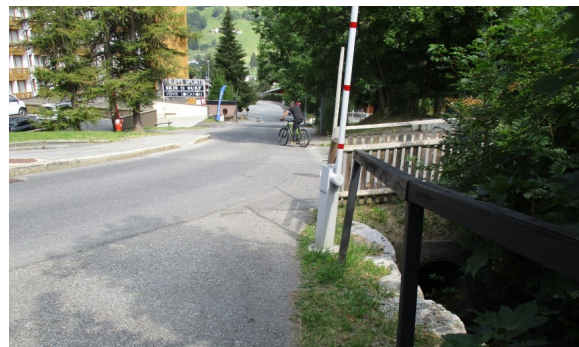
Figure 61: Entrée de la section busée du ruisseau, route du téléphérique
