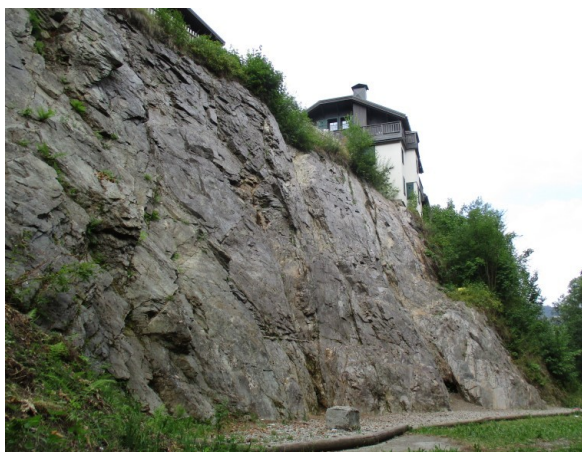
Figure 72: Falaise aménagée pour l'escalade à l'amont de la zone impactée par l'écroulement rocheux
