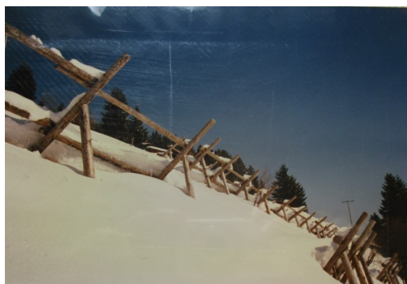
Figure 101: Paravalanche en bois construit dans la zone de départ de l'avalanche (1986) – source RTM
