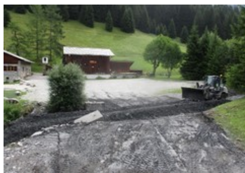
Figure 95: Curage au gué des Drets après la crue, le 27 juillet 2019
