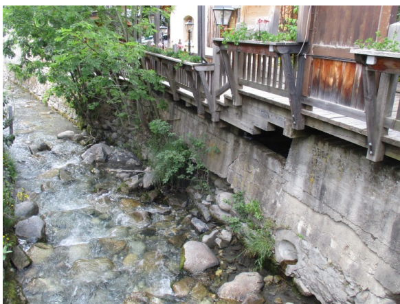
Figure 30: Érosion du mur et de la berge en rive droite au niveau d'une terrasse.
