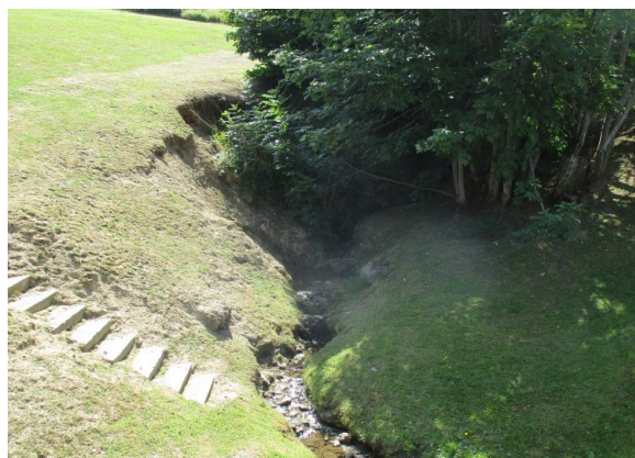
Figure 59: Érosion de berges à l'amont immédiat de la section busée
