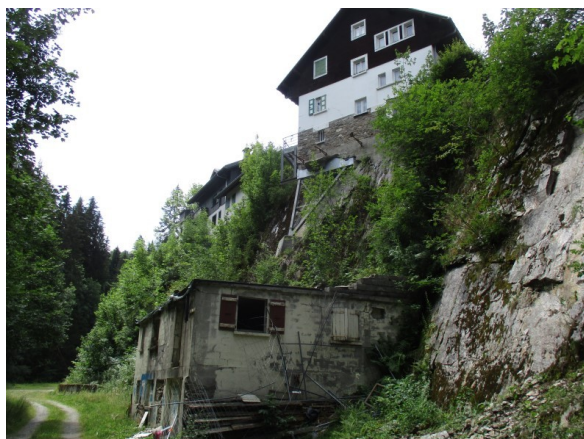
Figure 70: Bâtiment ayant été conforté par un bouton ancré
