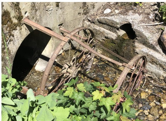
Figure 63: Entrée de la section busée, route des Perchets
