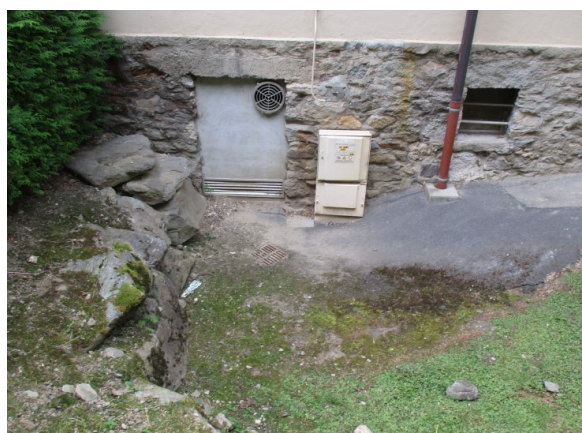
Figure 69: Panneau électrique extérieur au pied de l'immeuble
