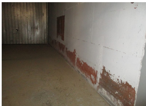
Figure 15: Laisse de crue dans les garages – 1 m d'eau environ
