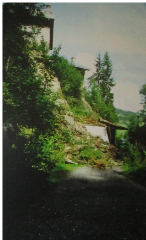
Figure 97: Masse de matériaux éroulée – source RTM
