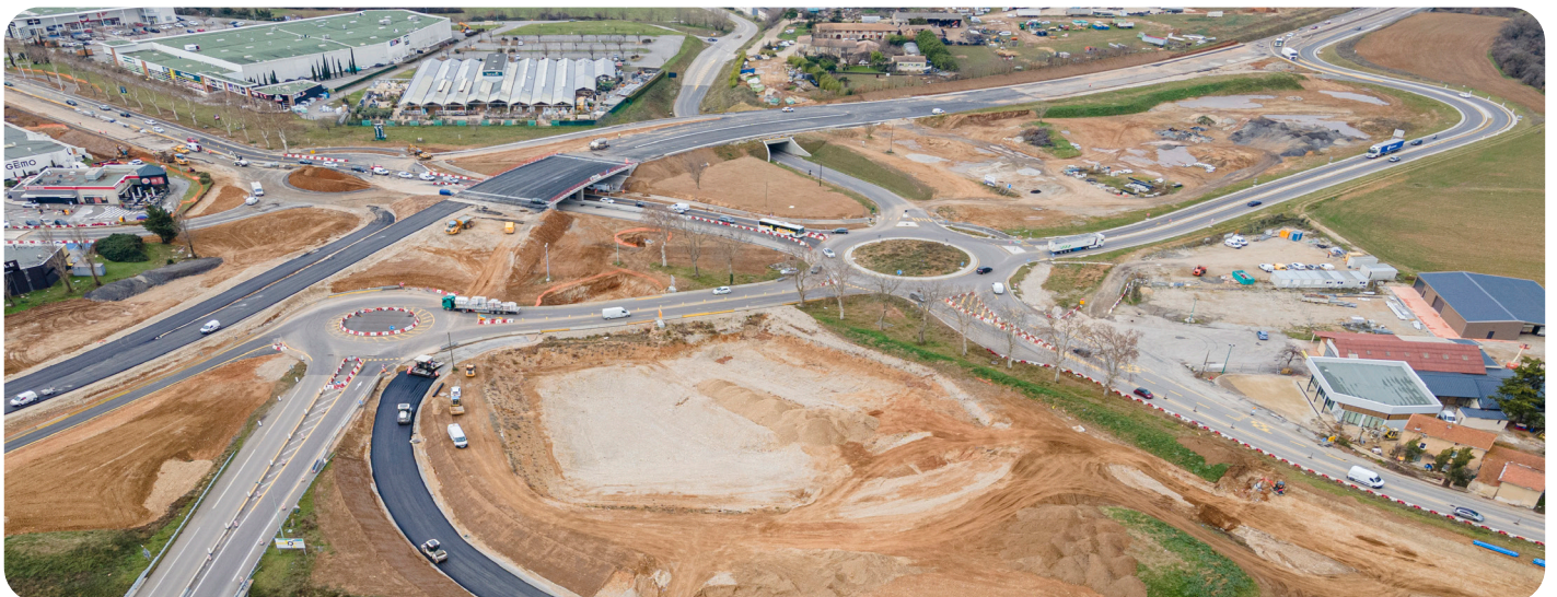
Vue aérienne du chantier (avenue de Romans à gauche, ouvrage d'art n°2 au centre et giratoire du Chantre à droite)
