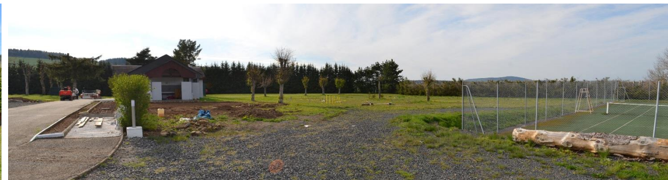
Vue vers tennis, aire jeu de pétanque, allée PMR en cours de travaux
