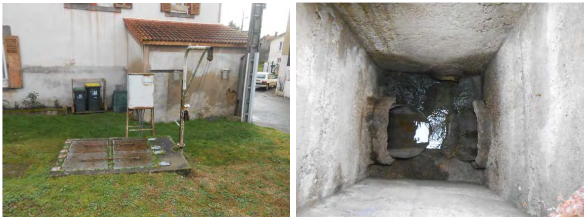
Poste de relevage du Creux et déversoir d'orage à l'entrée du PR
