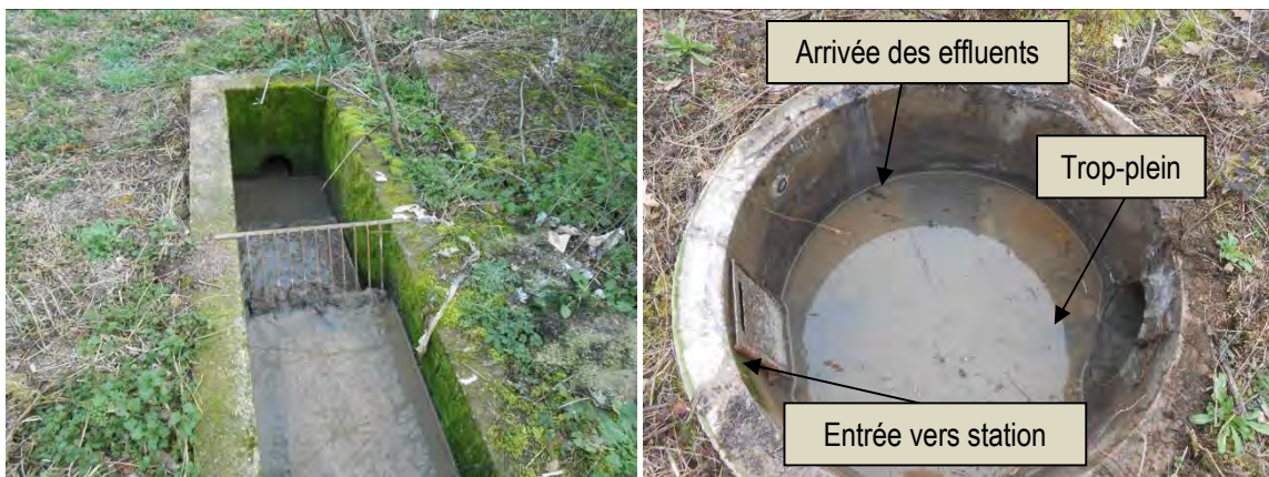
Dégrilleur non nettoyé et déversoir en charge
