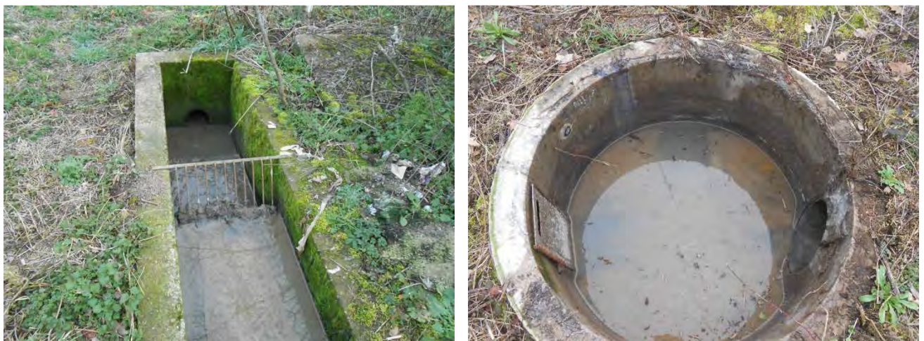
Dégrilleur provoquant la mise en charge du déversoir d'orage de la station de Chez Verdier
