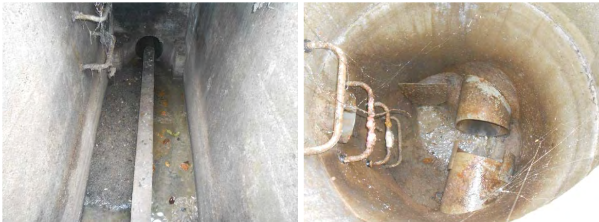
Dessableur et déversoir d'orage
