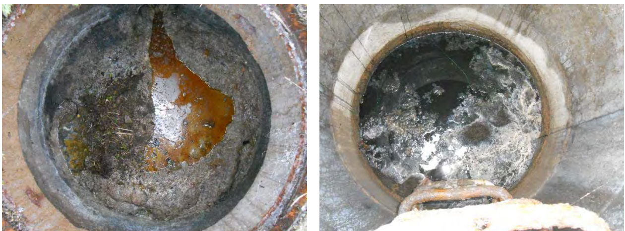
Exemple de mises en charge du réseau de Peschadoires
