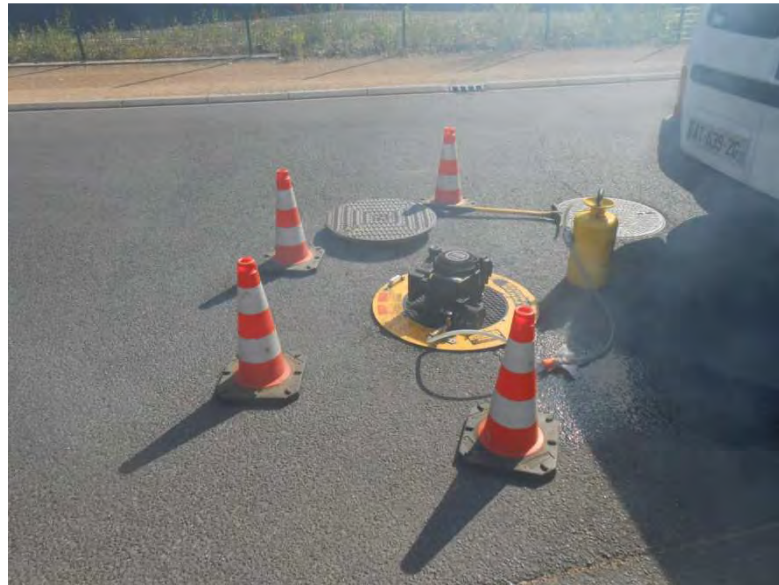
Générateur de fumée, ZA les Torrents
