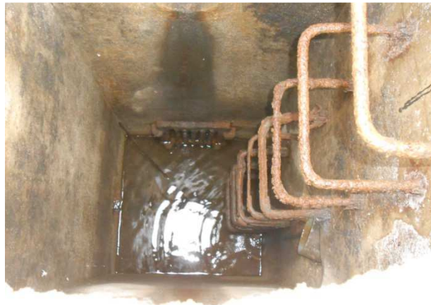
Grille dans les regards pluviaux du quartier des Cités
