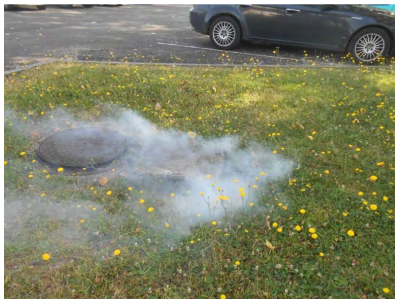
Sortie de fumée
