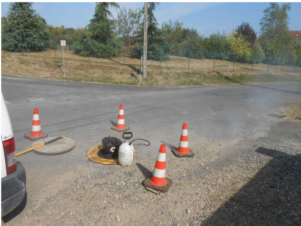
Générateur de fumée au croisement de la rue des Torrents et de la rue des Tulipes
