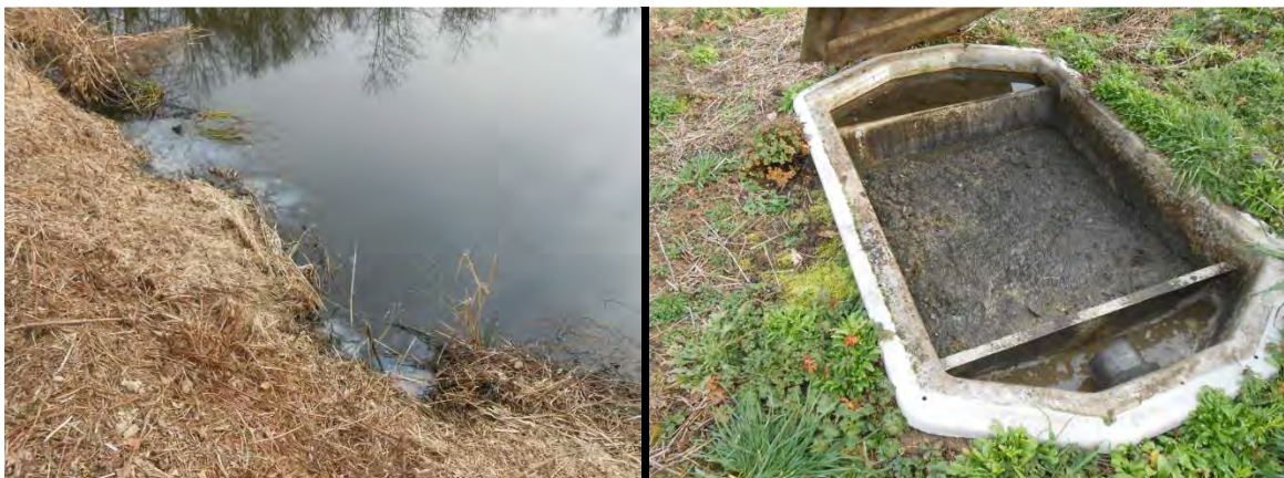
Plaques de graisses sur les bassins et dégraisseur
