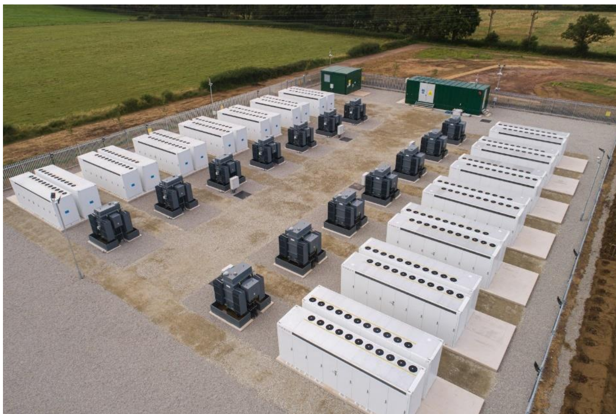
Figure 9 : Vue aérienne de la centrale de stockage de Contego (34 MW / 68 MWh), développée et opérée par Harmony Energy
