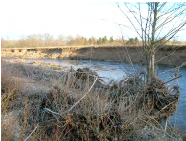
Érosion sur le Lignon vers les Périchons
