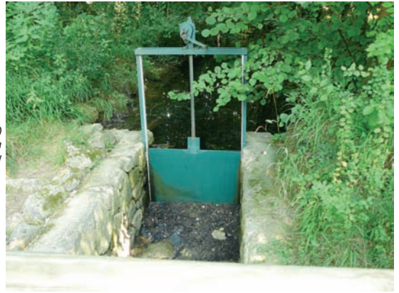
Eclusette (g) pour la gestion des niveaux d'eau
