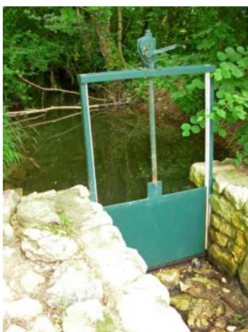
Vanne de l'exutoire du ruisseau de la vanne. Photo RNML
