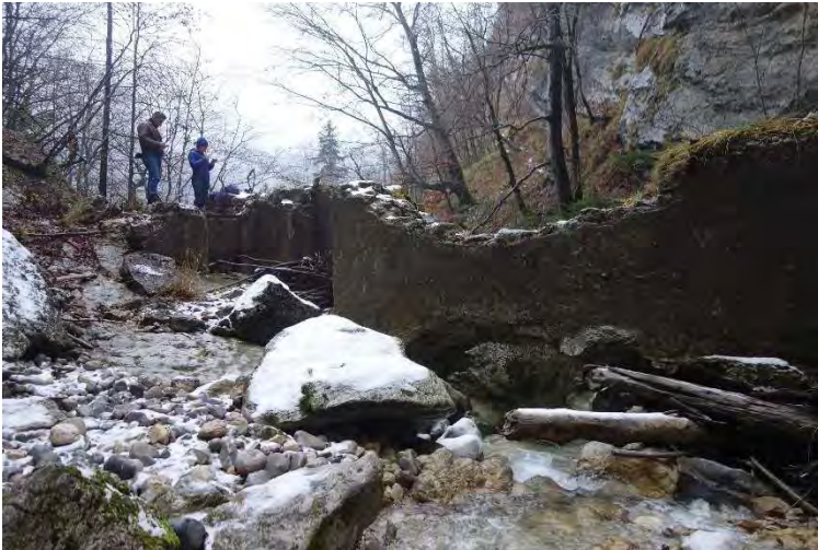
GC existant : pied de l'ouvrage détruit pour laisser passer l'eau et crête d'ouvrage abaissée
