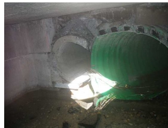
Evacuation des eaux
