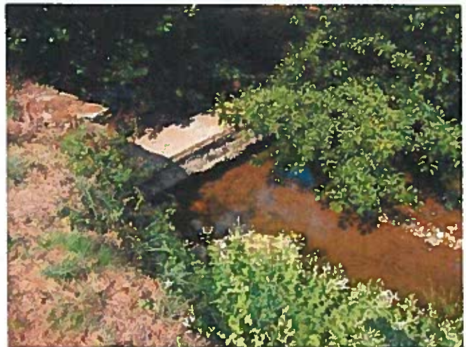
Incision du lit en amont de la RN 122 – conduite d'eaux usées perchée au dessus du lit
