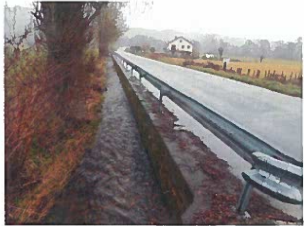
L'Arcambe en aval du seuil de la RD19 (modification du profil en long sur un secteur très anthropisé en bordure de routé départementale)
