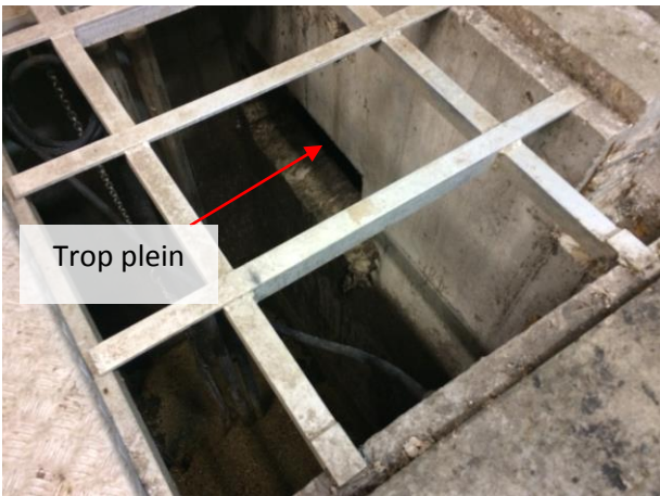
Figure 5 : Trop-plein du poste de relèvement en tête de station
