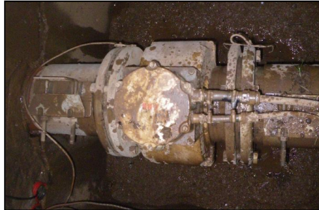
Vanne électromagnétique de Revel-Tourdan
