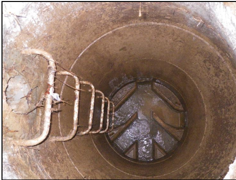
Regard contenant la surverse
