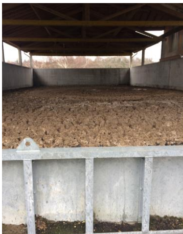
Figure 31 : Aire de stockage des boues (1)
