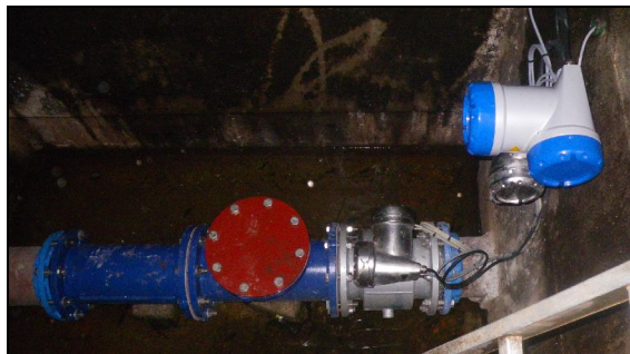
Vanne électromagnétique de Pajay
