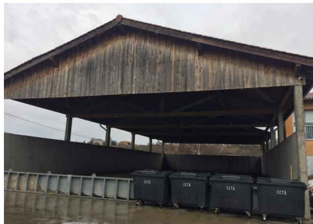
Figure 32 : Aire de stockage des boues (2)
