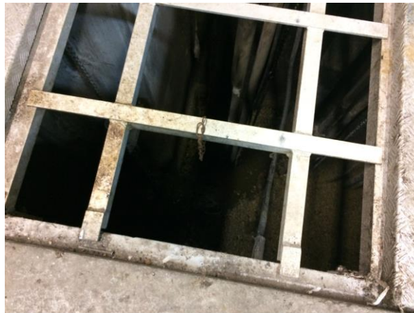
Figure 3 : Arrivée des eaux usées et dégrilleurs dans la bache de reprise du poste de relèvement
