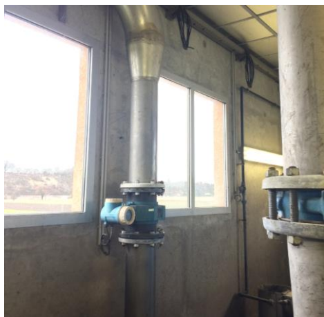
Figure 12 : Débitmètre à l'entrée des tamis rotatifs
