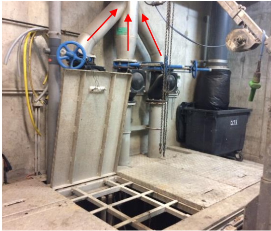
Figure 4 : Canalisations reliées aux trois pompes de relèvement
