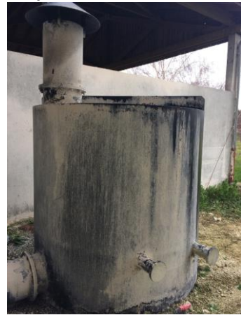
Figure 8 : Charbon actif pour la désodorisation
