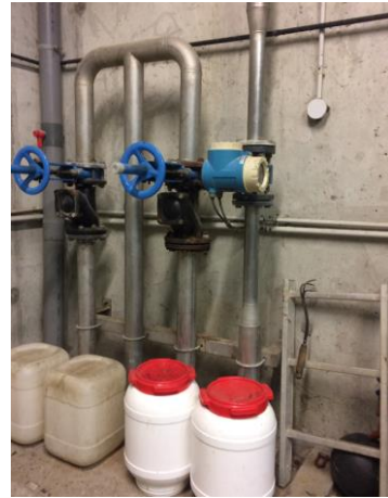
Figure 7 : Vanne et débitmètre en entrée de la fosse récupérant les matières de vidange
