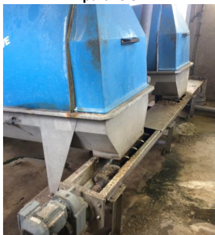
Figure 14 : Vis sans fin transportant les matériaux séparés
