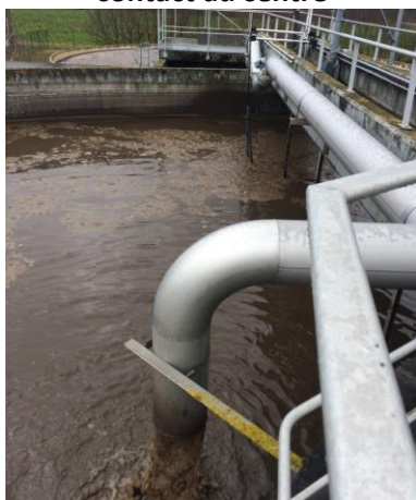
Figure 18 : Bassin d'aération Sortie du circuit de recirculation
