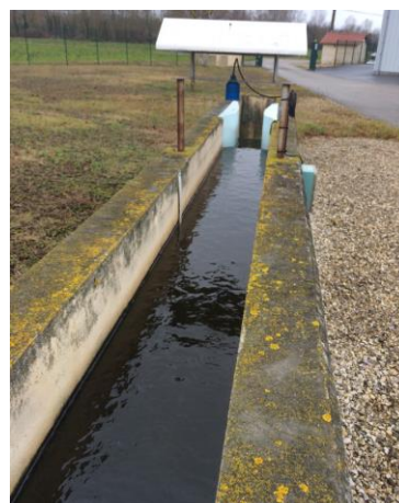
Figure 25 : Rejet de la STEP et dispositif de mesure du débit
