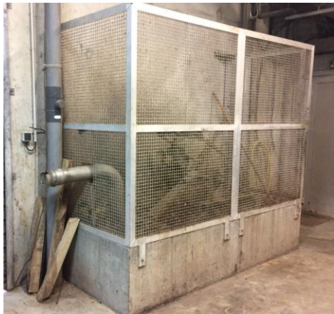
Figure 6 : Dépotage camion de vidange et dégrilleur
