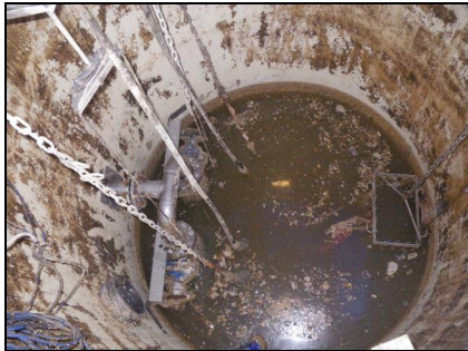
Poste de refoulement de Marcollin
