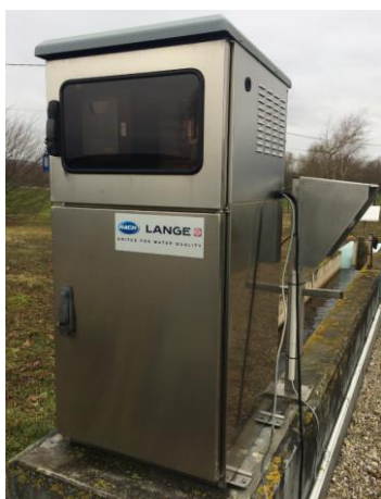
Figure 24 : Préleveur automatique en sortie de STEP
