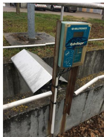
Figure 11 : Mesure du débit by passé
