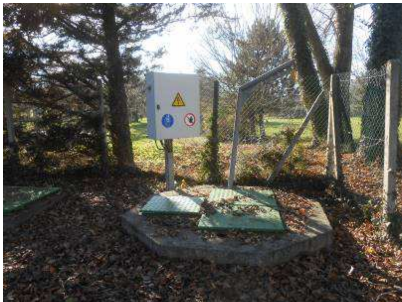
Poste de relevage d'Orbeil
