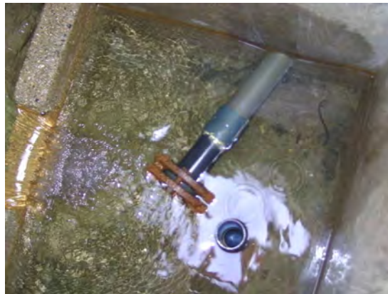
2 ème bassin avec départ et trop -plein
