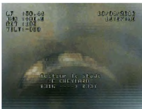
Décalage de tuyau
