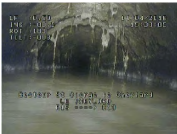
Etat général de la canalisation
