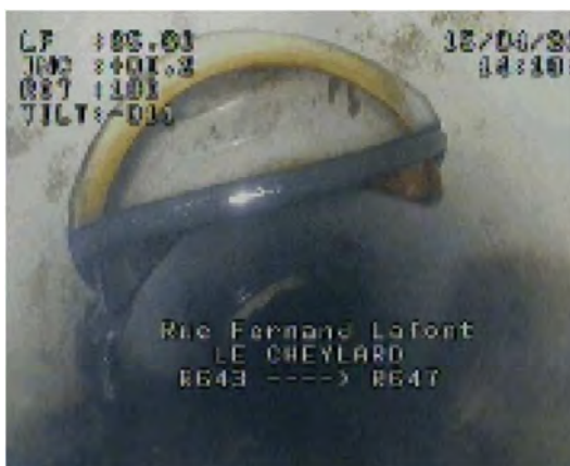
Joint déboîté rue Lafont
