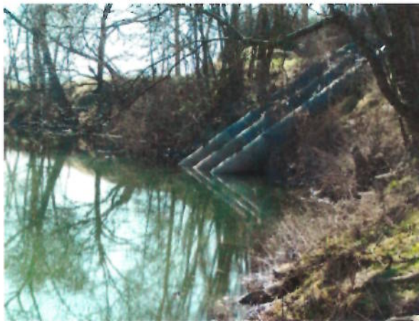
Photo 3. Tubes plongeurs de l'ASA du Sud Lembron (conception qui est reprise pour le projet de l'ASL des Turlurons)
