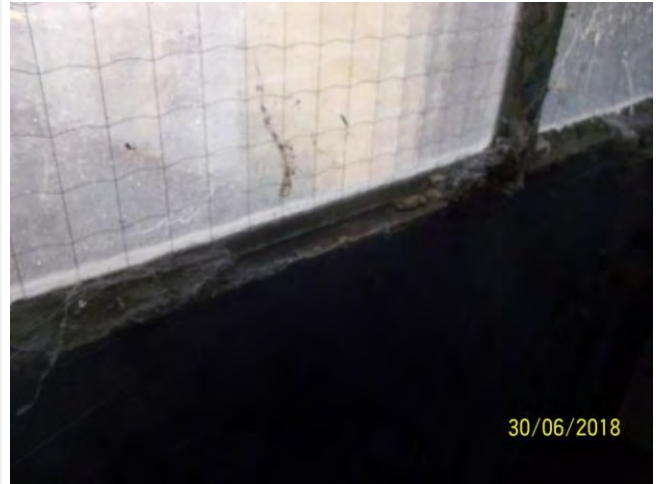
Composant : Joint de vitrage / menuiserie 6 (a) P4-AR-18-LE-079779-01 MASTIC Porte Vitrée située en façade avant du bâtiment
