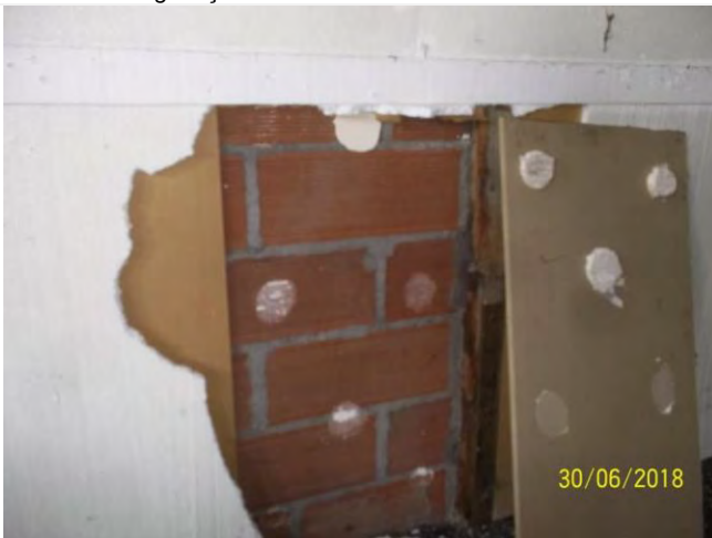
Composant : Colle 21 (N) P7-AR-18-LE-079782-01 COLLE DOUBLAGE POLYSTYRENE côté façade avant Piste
