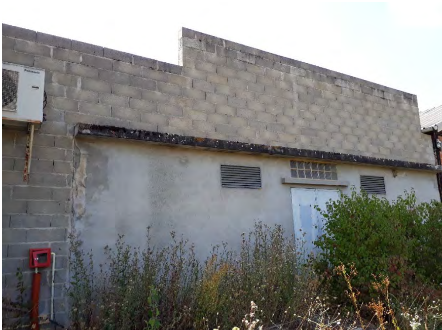
LOCAL TRANSFORMATEUR FACADE OUEST
