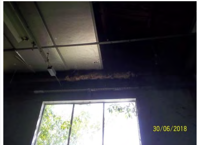
Composant : Calorifugeage 24 (N) sur réseau Local TRANSFO
