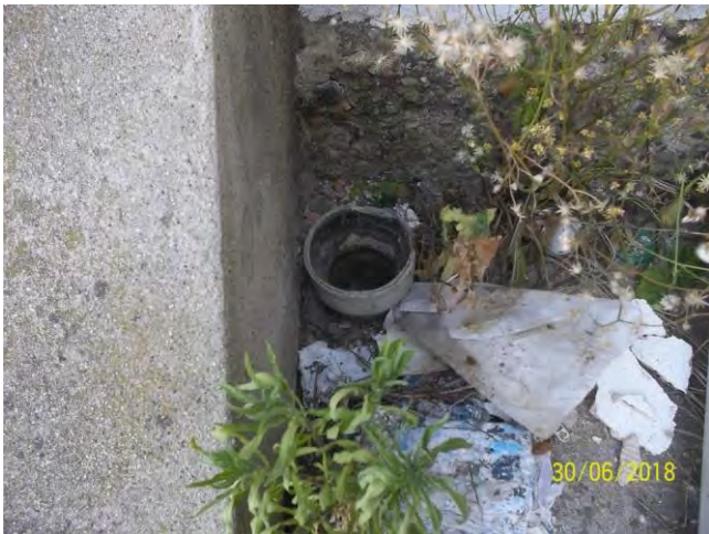
Composant : Conduit de fluide (eau) 8 (a) P23-AR-18-LE-079798-01 reste d'un CONDUIT situé à droite de la porte d'entrée du Karting,
