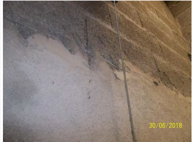
Composant : Peinture ou enduit 9 (a) P12-AR-18-LE-079787-01 ENDUIT sur PARPAING Local WC au-dessus du Faux-plafond
