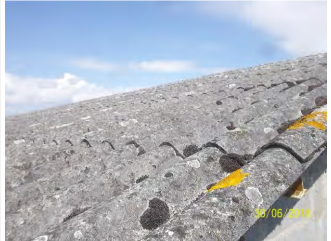
Composant : Plaques ondulées en toiture 2 (a) P25-AR-18-LE-079800-01 COUVERTURE PARTIELLE du Batiment Principal
