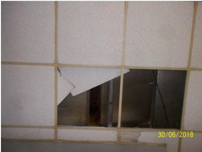
Composant : Faux plafond 13 (N) au-dessus des dalles de Faux PLAFOND ARMSTRONG Local Réception Pilote
