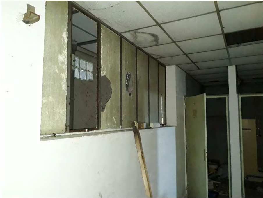
KARTING LOCAL TRANSFO DEPUIS LOCAUX SOCIAUX (vue depuis dégagement)
