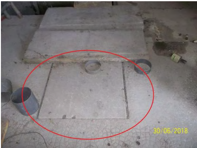
Composant : Panneaux rigides (cloisons, gaines, plafonds) 10 (a) P19-AR-18-LE-079794-01 PLAQUES ISOLANTES Local TRANSFO
