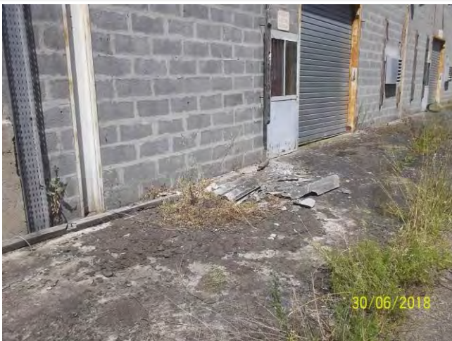
Composant : Plaques ondulées en toiture 4 (a) P26-AR-18-LE-079801-01 PLAQUES ONDULEES situées à l'arrière du bâtiment
