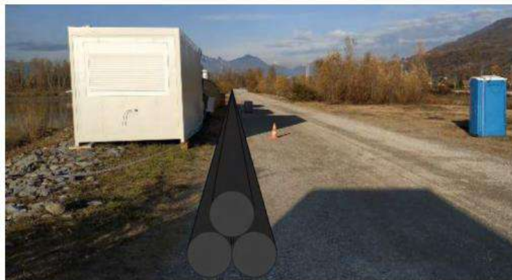
Figure 38 : Installations de chantier et stockage temporaire des canalisations (les bungalows pourront être situés de l'autre côté du chemin)
