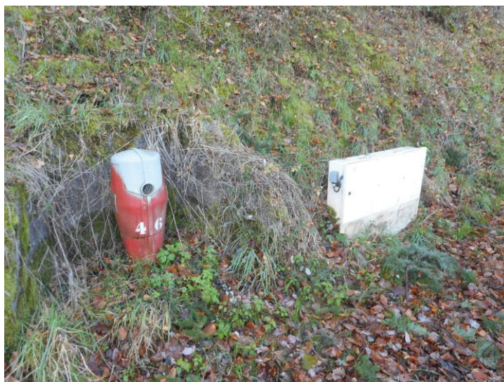
22. Borne incendie et coffret ENEDIS à proximité de l'Auberge
