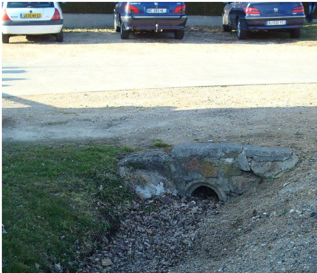
Mauvais entretien des passages busés d'accès aux parcelles
