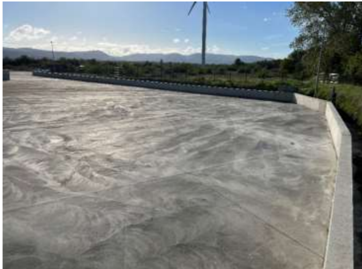
Plateforme SOLUWASTE : angle sud-ouest de l'aire bétonnée, muret béton délimitant l'aire de rétention des eaux pluviales et des eaux d'extinction incendie. Un joint expansif assure l'étanchéité entre le mur et la surface bétonnée (cliché TS 09/22)
