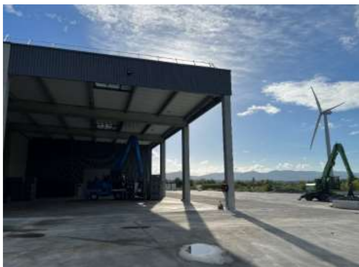
Plateforme SOLUWASTE : Bâtiment partie ouverte vu depuis l'aire bétonnée de stockage des déchets vers le sud-est (cliché TS 09/22)
