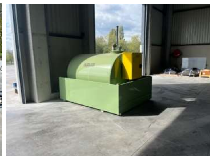
Plateforme SOLUWASTE : Stockage de 3000 l d'hydrocarbures et pompe de distribution sur cuvette de rétention elle-même sur dalle étanche, dans la partie fermée du bâtiment (cliché TS 09/22)
