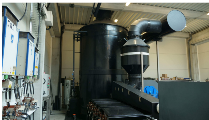
Figure 6 : Captation des bains, dévésiculeur et tour de lavage des gaz – Chromage Dur France
