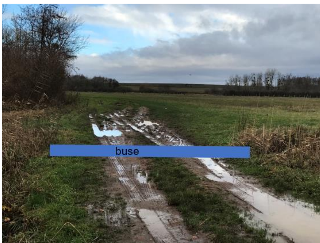
Photo 3 : du chemin au droit de la buse à remplacer.
