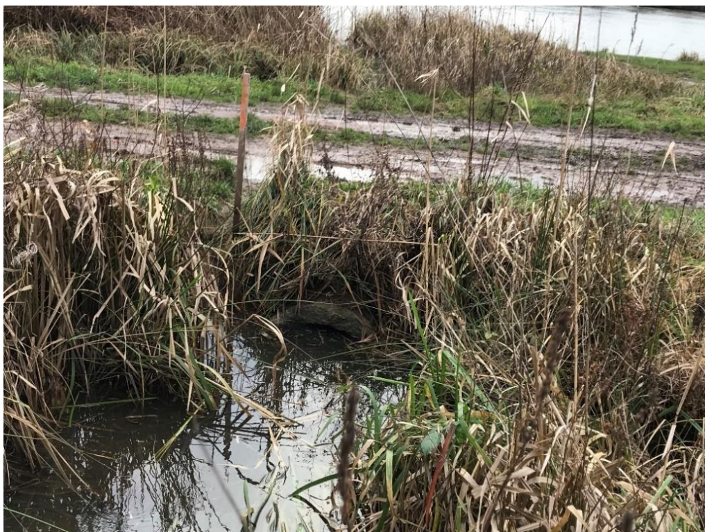
Photo 2 : de la buse à remplacer.
