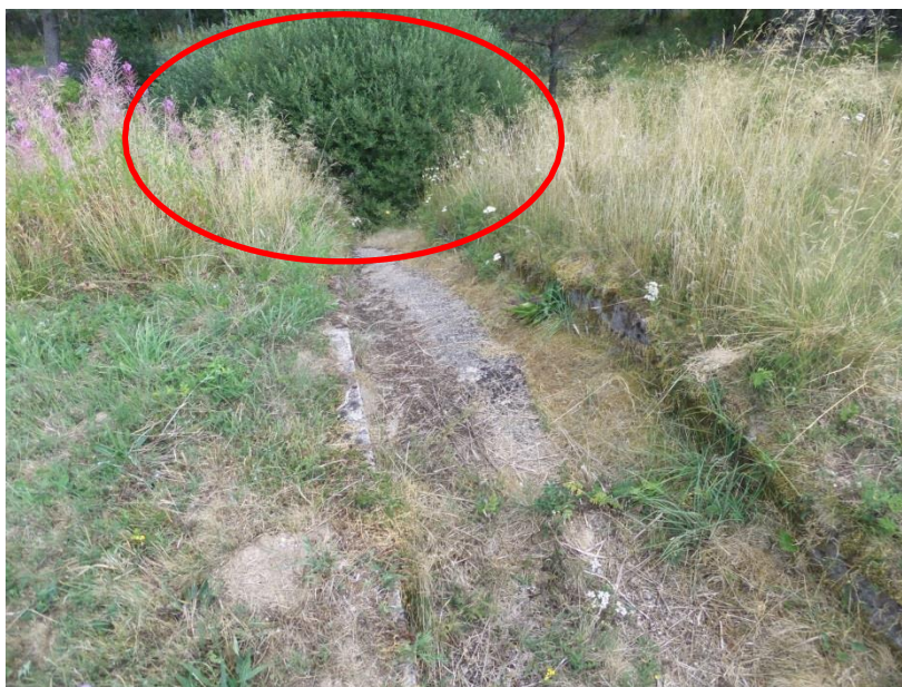
Figure 13 : coursier de l'évacuateur de crues
