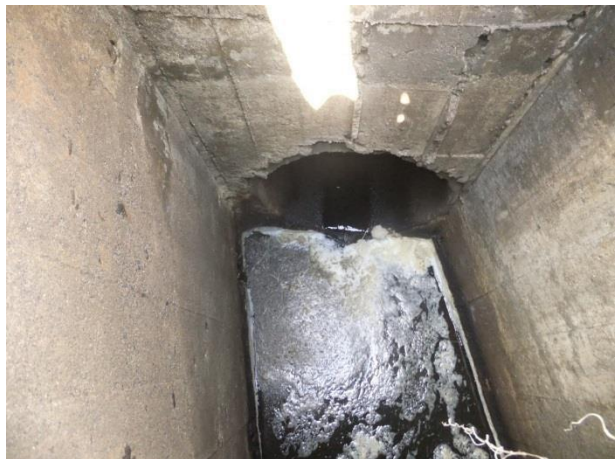
Figure 4 : Regard de visite de la conduite d'alimentation
