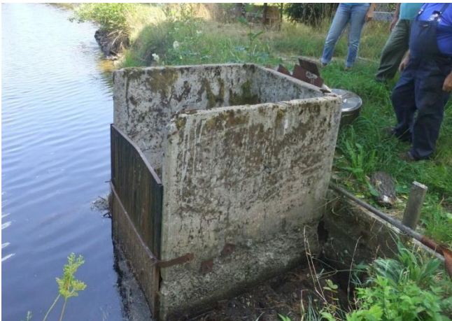
Figure 3 : Moine du plan d'eau amont et départ de l'alimentation
