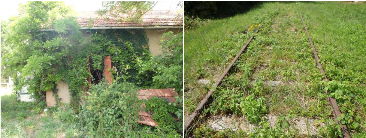
Figure 19 : Maison abandonnée (à g.) et voie de chemin de fer délaissée (à d.)
