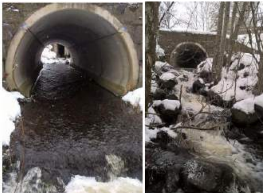
A gauche : Radier du busage de la RN 122 ; à droite : chute aval
