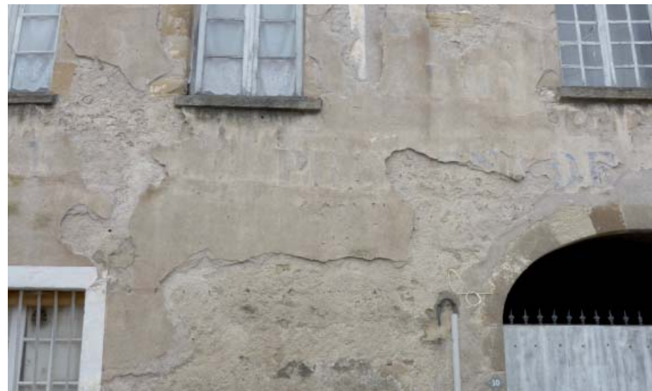
la dégradation de l'enduit dévoile les techniques de mise en oeuvre (couche d'accrochage, «gobetis», enduit de finition et décor en badigeon (enseigne))
