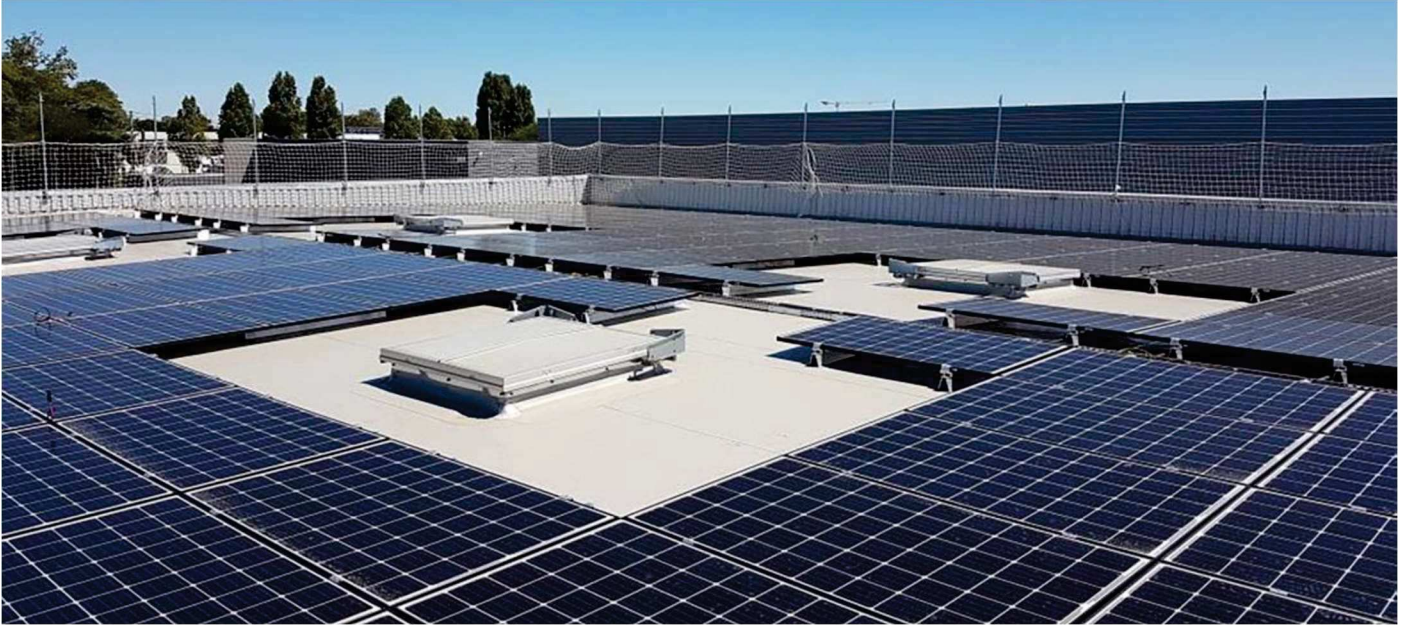
Exemple de panneaux photovoltaïque en couverture
