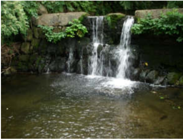
Figure 24 : Seuil occasionnant une rupture de la continuité écologique du Janon à 40 m en aval de sa confluence avec le Ricolin
