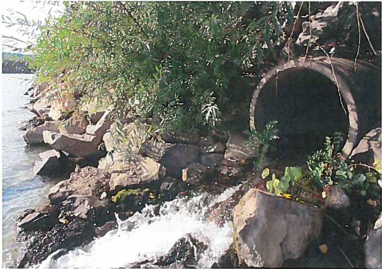
Photo 3 : Point de rejet Usine après traitement
