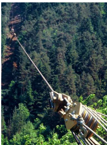
Figure 2 Ligne de câble long. Source : ONF
