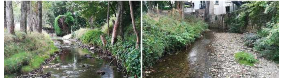
Figure 17 : Talus et murs de soutènement favorisant les phénomènes de « chasses » et l'incision du lit mineur du Janon lors des crues
