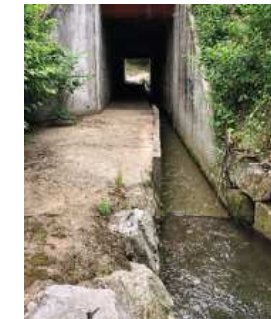
Franchissabilité piscicole limité dans l'ouvrage de la RN 88
