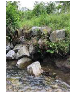
Protection de berges en enrochements effondrés
