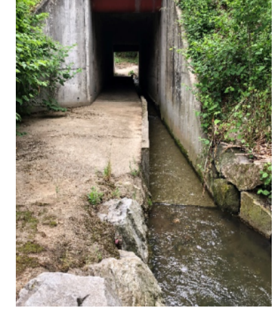
Franchissabilité piscicole limitée dans l'ouvrage de la RN88
