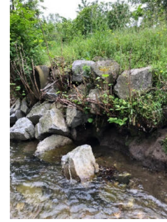
Protection de berges en enrochements effondrés
