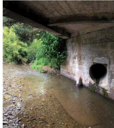
Présence de plusieurs réseaux d'assainissement EP
