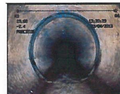
Déboîtement visible au droit de chaque assemblage
