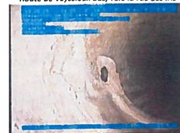
Exemple d'anomalies constatées perforation
