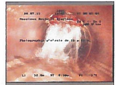
Branchement drainant des eaux claires parasites permanentes
