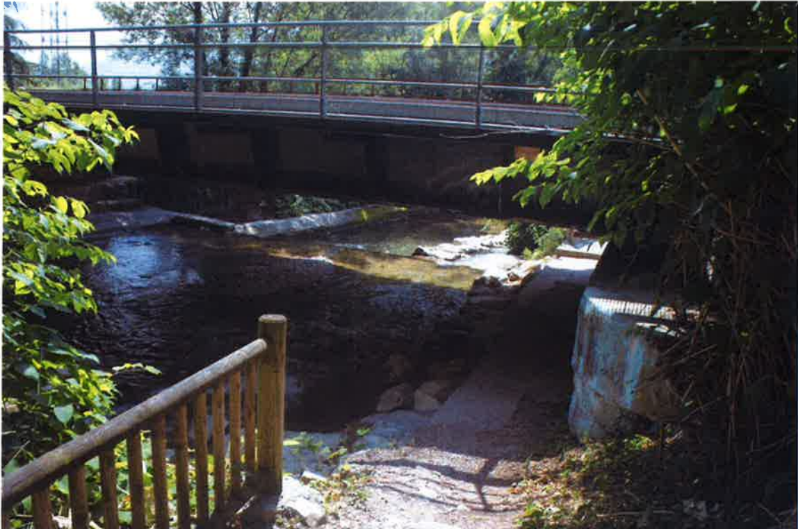
Vue 5 : vue sous le pont SNCF depuis la rive droite (Source : EPODE Juin 2017)
