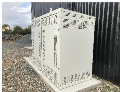
Exemple d'une armoire technique
