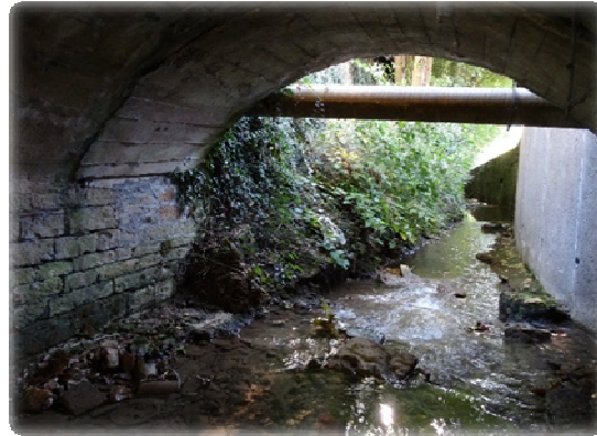
Pont routier défavorable sur le site, le plafond est entièrement bétonné et l'environnement proche est très dégradé (recalibrage, urbanisation, espèces végétales invasives etc.)
