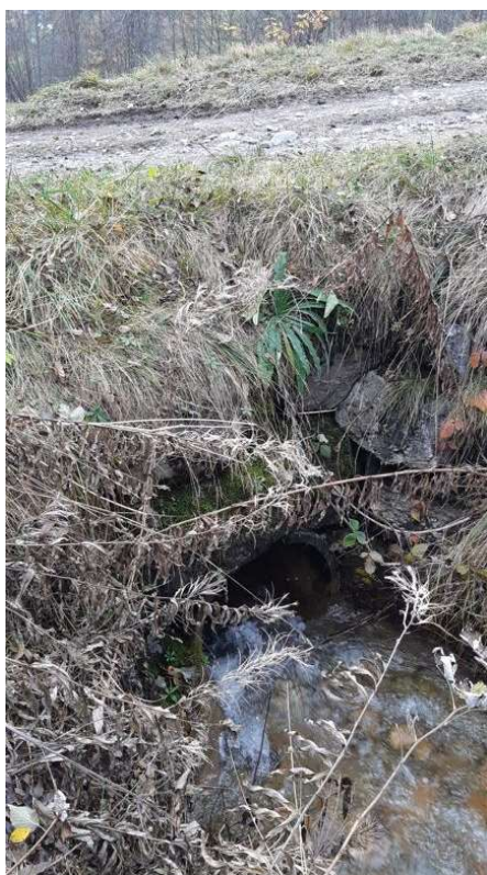
Figure 24 : Passage busé du torrent des Terreaux
