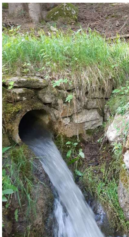
Figure 25 : Passage busé du ruisseau du Nanty
