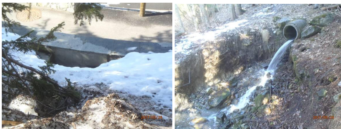
Figure 2 Le busage (avaloir et restitution) au niveau du carrefour en amont de Cote Martel
