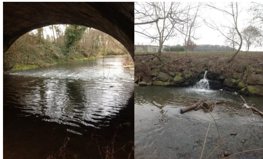
Photo de gauche : pont du chemin du Riottier ; Photo de droite : rejet des eaux
