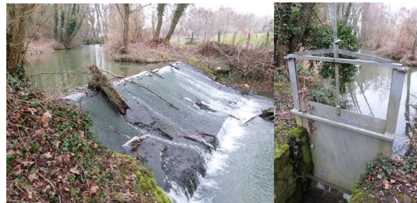
Obstacles présents en amont de la STEP ; Photo de gauche : ancien seuil à moulin ; Photo de droite : vanne
