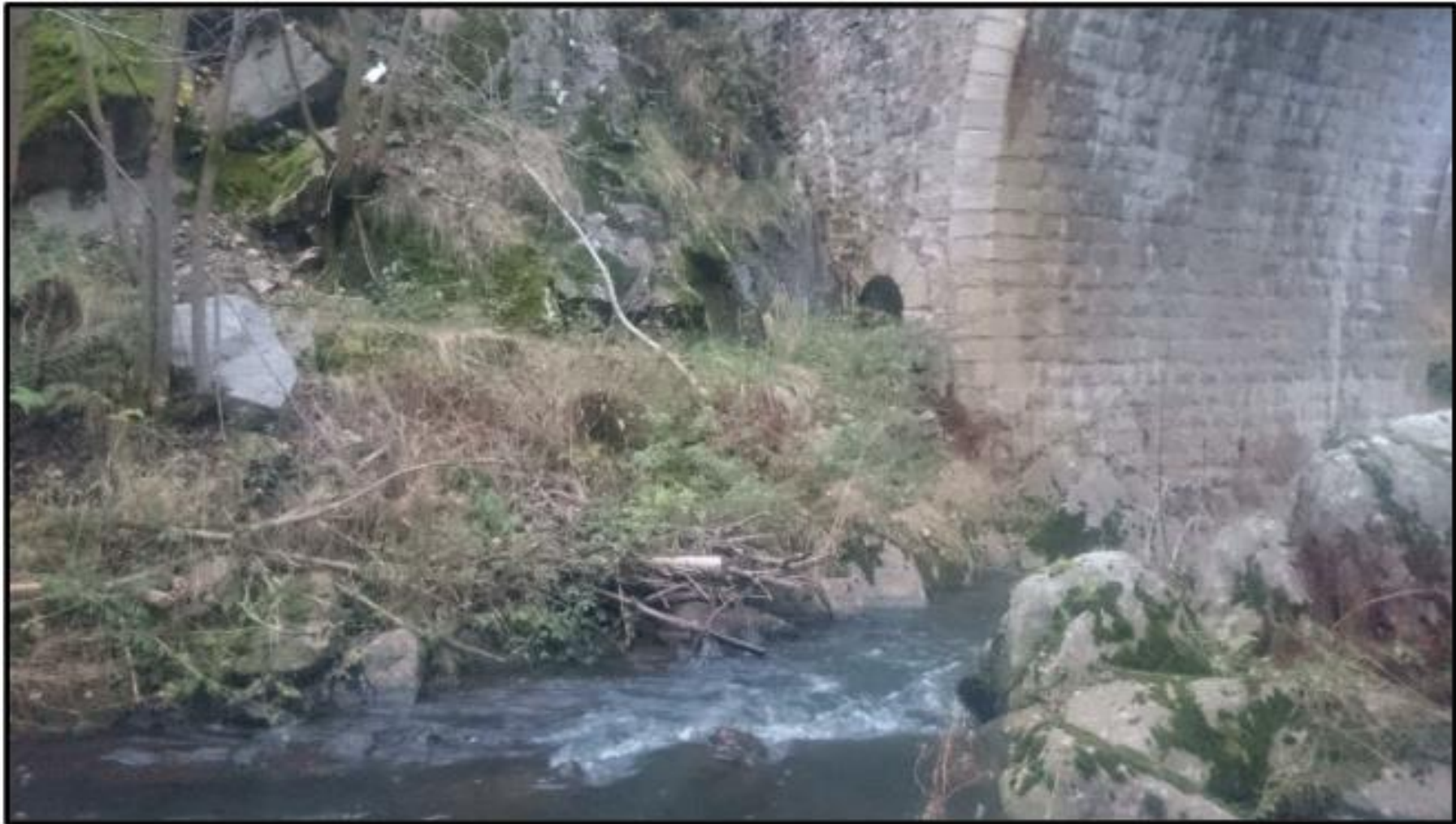
Figure 3 : Réserve pour le canal déjà existante dans la pile du Pont – vue amont
