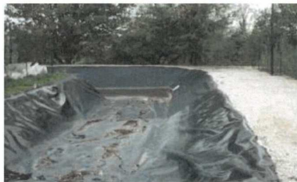
Figure 54 : Bassin étanche, avenue de la Libération, Ambarès-et-Lagrave (Communauté Urbaine de Bordeaux, 2014)
