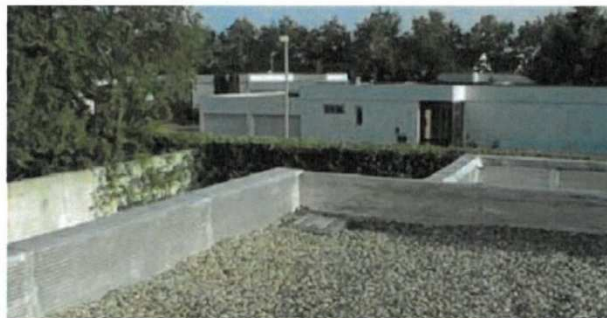
Figure 51 : Toiture-terrasse stockante (Communauté Urbaine du Grand Lyon, 2008)
