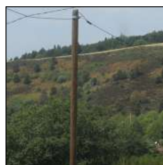
Poteau en bois
