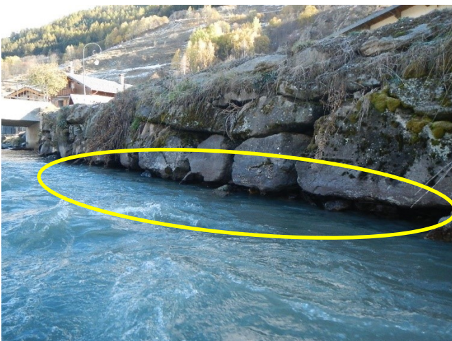
Figure 10 : Vue sur le pied de parement affouillé
