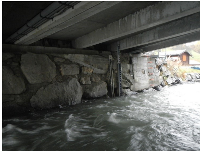
Figure 100 : Localisation de la station de mesure de débits (pont n°1)
