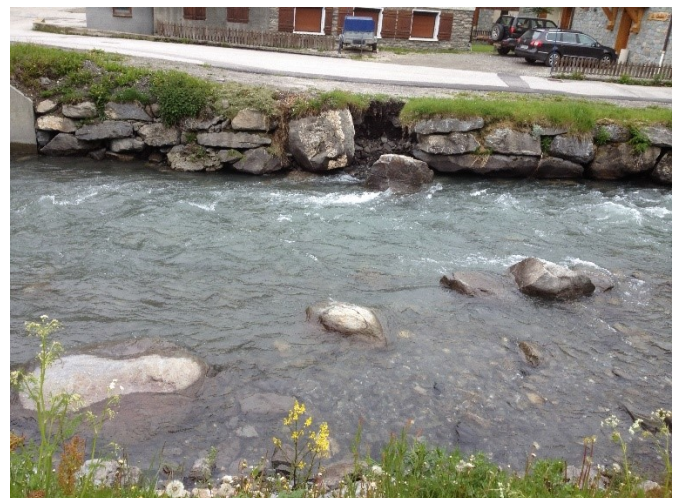
Figure 11 : Effondrement d'un bloc lors de la crue de 2014
